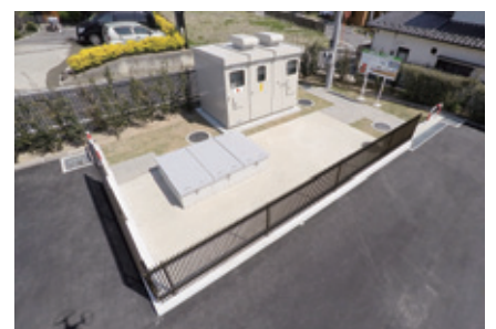
染屋浄水場小水力発電設備
