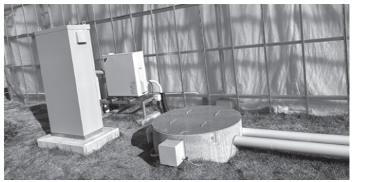
地中熱ヒートポンプ
