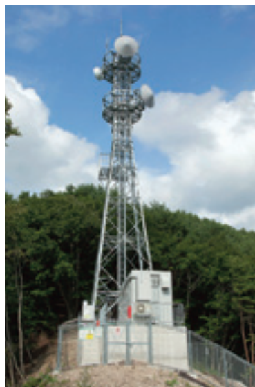
防災行政無線 真田中継局 安全・安心のまちづくりのため市内全域を対象エリアとしたデジタル式の防災行政無線を整備しました。
