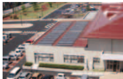
「ひとまちげんき・健康プラザうえだ」の屋上に設置された太陽光発電パネル
