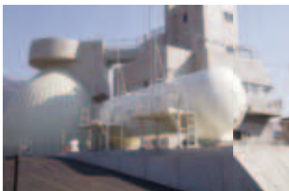
上田下水浄化センターの汚泥消化槽とガスホルダ
