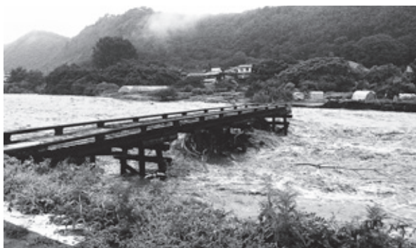
平成18年7月の豪雨で増水した依田川と損壊した馬坂橋(腰越)
