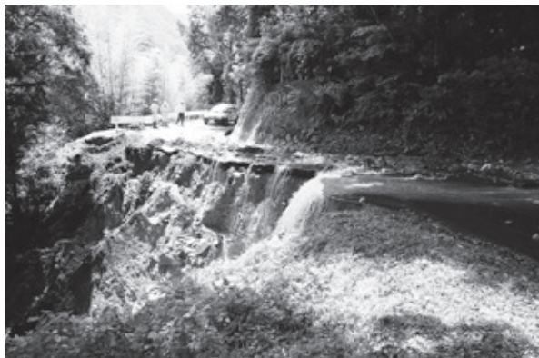
平成22年8月の局地的豪雨で崩落した道路(真田町傍陽)
