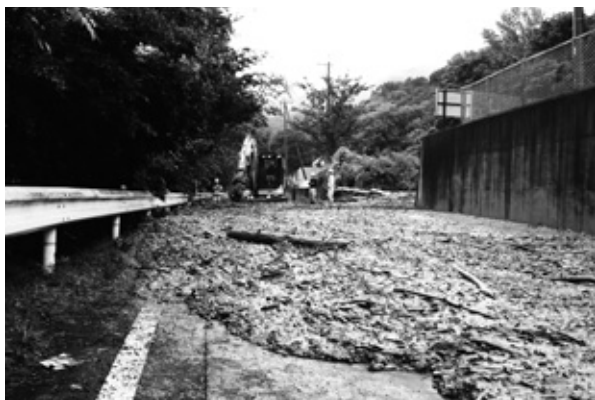
平成28年9月台風第16号 市内(小牧)の被害状況
