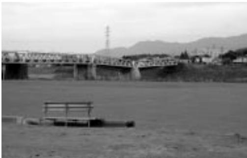
▲橋脚の傾いた大石橋と復旧作業が終わった大石グラウンド
