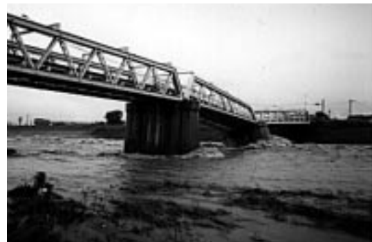
▲橋脚が傾いた上田市側の大石橋
