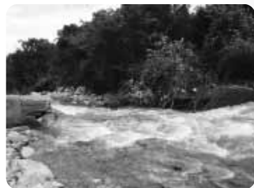
9月豪雨災害によりこわれた大布頭頭首工
