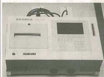
上田市役所本庁舎3階の事務室に設置されている計測地震計の処理部(NTT回線で長野県庁生活環境部消防防災課と結ばれている)
