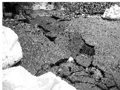
須川地区へ通じる県道の破損
