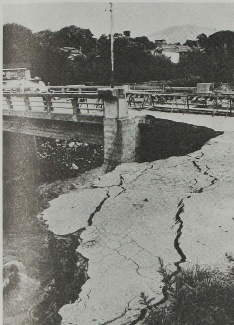
神川・境橋付近の護岸が損壊
