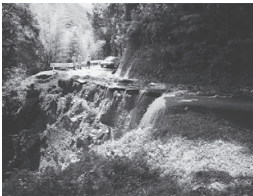
真田町傍陽の上横道地区では市道が崩落し車の通行ができなくなった
