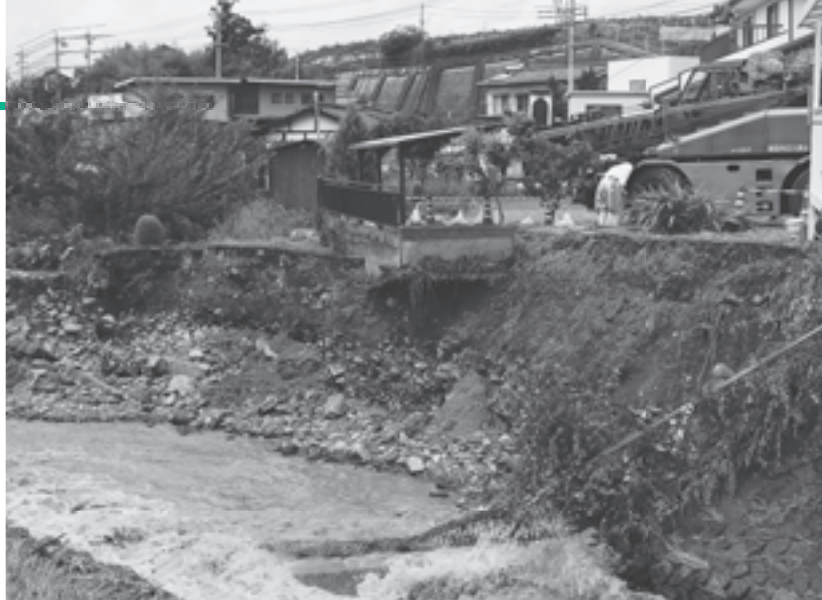
矢出沢川の氾濫により避難勧告が出された蛇沢地区
