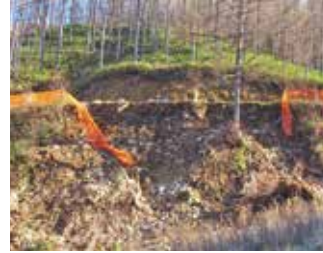
▲林間コースの土砂崩れ
