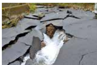
出水により路面がえぐりとられ、波打つような状態
