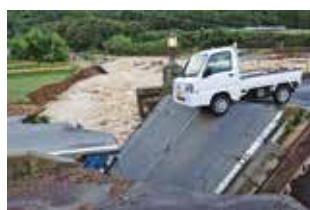
上流の護岸が流出し道路が陥没
