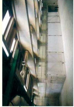
◀建物内イメージ (イタリアのトンネルコンポスト施設)
