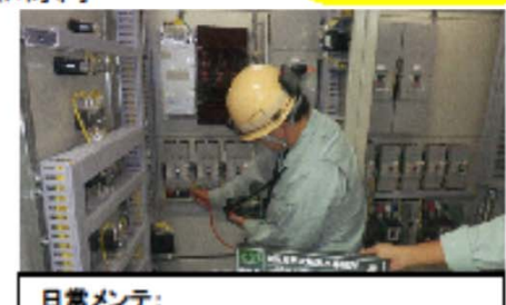
日常メンテ： 主水門制御電源盤点検
