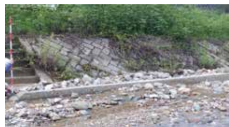
土砂流入により閉塞した中茂沢頭首工
