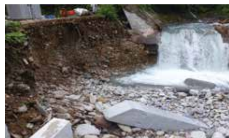
武石川護岸崩落および権現頭首工流出
