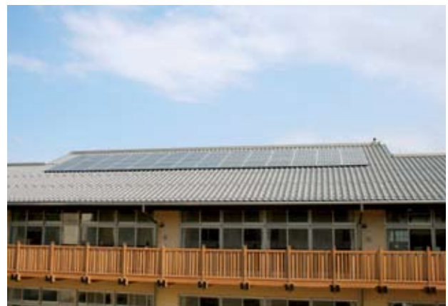
中塩田小学校に設置された太陽光発電システム
