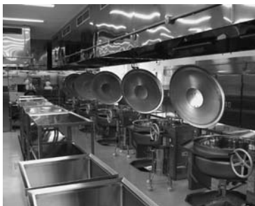
給食センター内の加熱調理室
