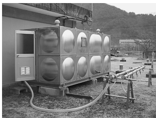
腰越浄水場の10トン給水タンク
