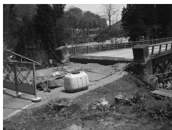
震災により地盤沈下した栄村の道路
