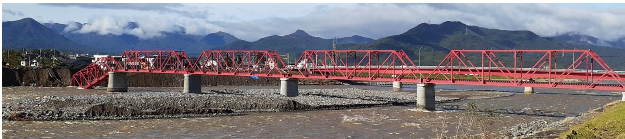
図 2-7 令和元年東日本台風の被害 千曲川左岸堤防の欠損と上田電鉄・別所線橋梁の崩落（諏訪形）
