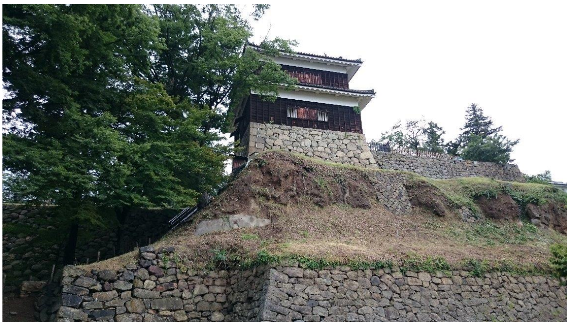
写真 11 平成 28 年尼ヶ淵崖面一部崩落
