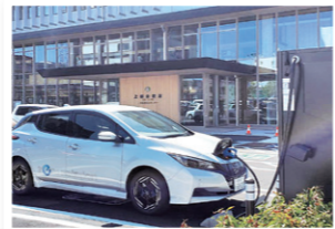
5 庁舎の太陽光発電を活用したEV急速充電設備
