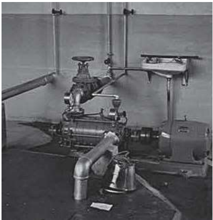
東部簡易水道 林之郷ポンプ設備(昭和36年)
