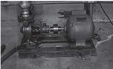
東部簡易水道 大日ノ木配水池 減菌室カスケードポンプ(昭和32年)
