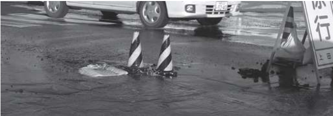
古舟橋 前破裂事故(平成15年2月)
