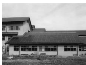
塩田中学校に設置されている太陽光発電システム
