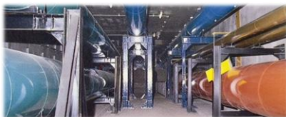
筑波研究学園都市の地域冷暖房共同溝
