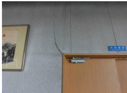
壁のひび割れ
