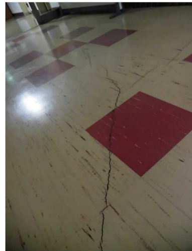
床のひび割れ
