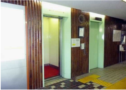
老朽化した昇降機
