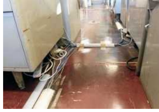
露出している配線・コードの状況
