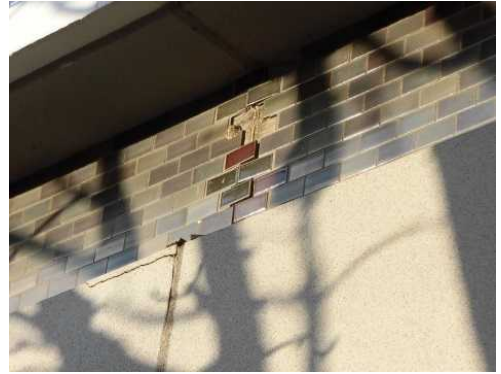
破損している外壁タイル
