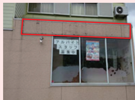
落下した後の壁面
