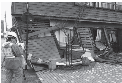
被害建築物応急危険度判定支援： 中能登町、輪島市（派遣職員撮影）
