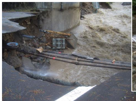
令和元年10月 台風19号 被災状況
