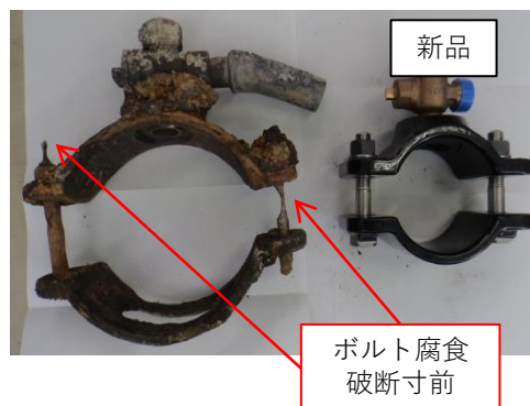
ボルトの腐食
