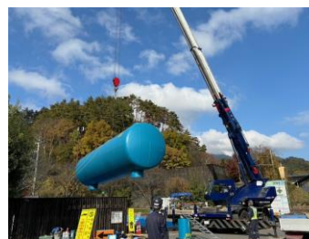
写真は市内別箇所での様子です。
