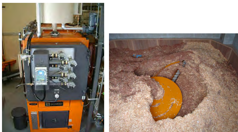
北海道下川町・五味温泉における木質バイオマスボイラーの導入例
