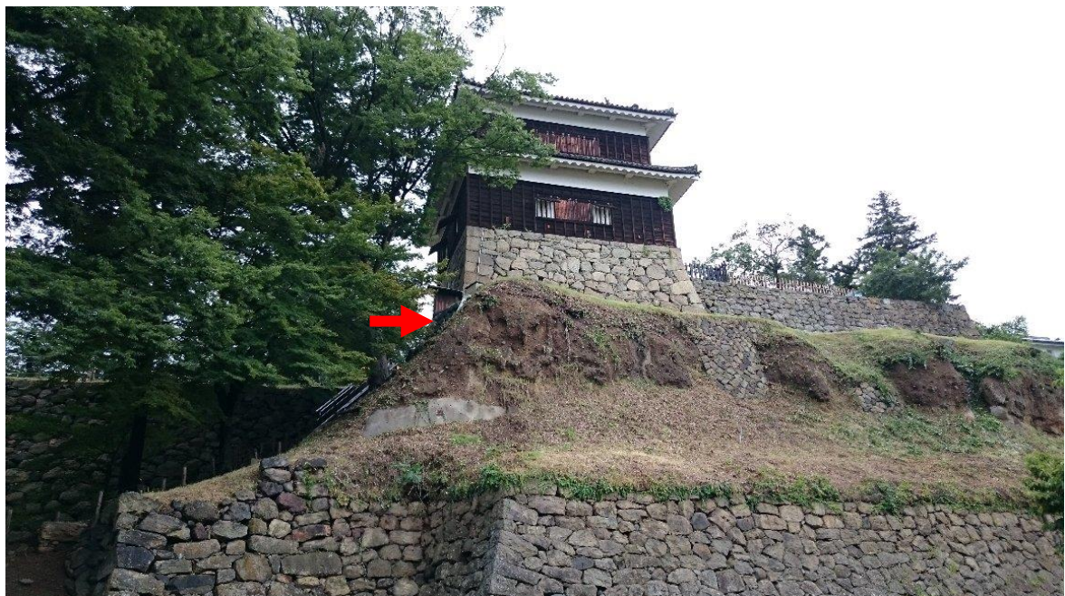
写真 12 平成 28 年尼ヶ淵崖面一部崩落
