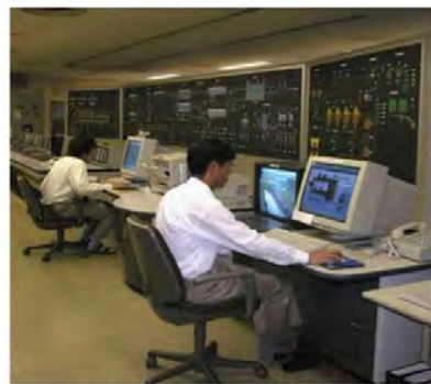
下水道施設の集中監視
