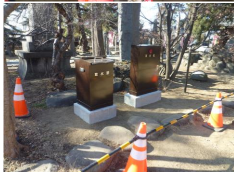
動力ポンプ、放水銃
