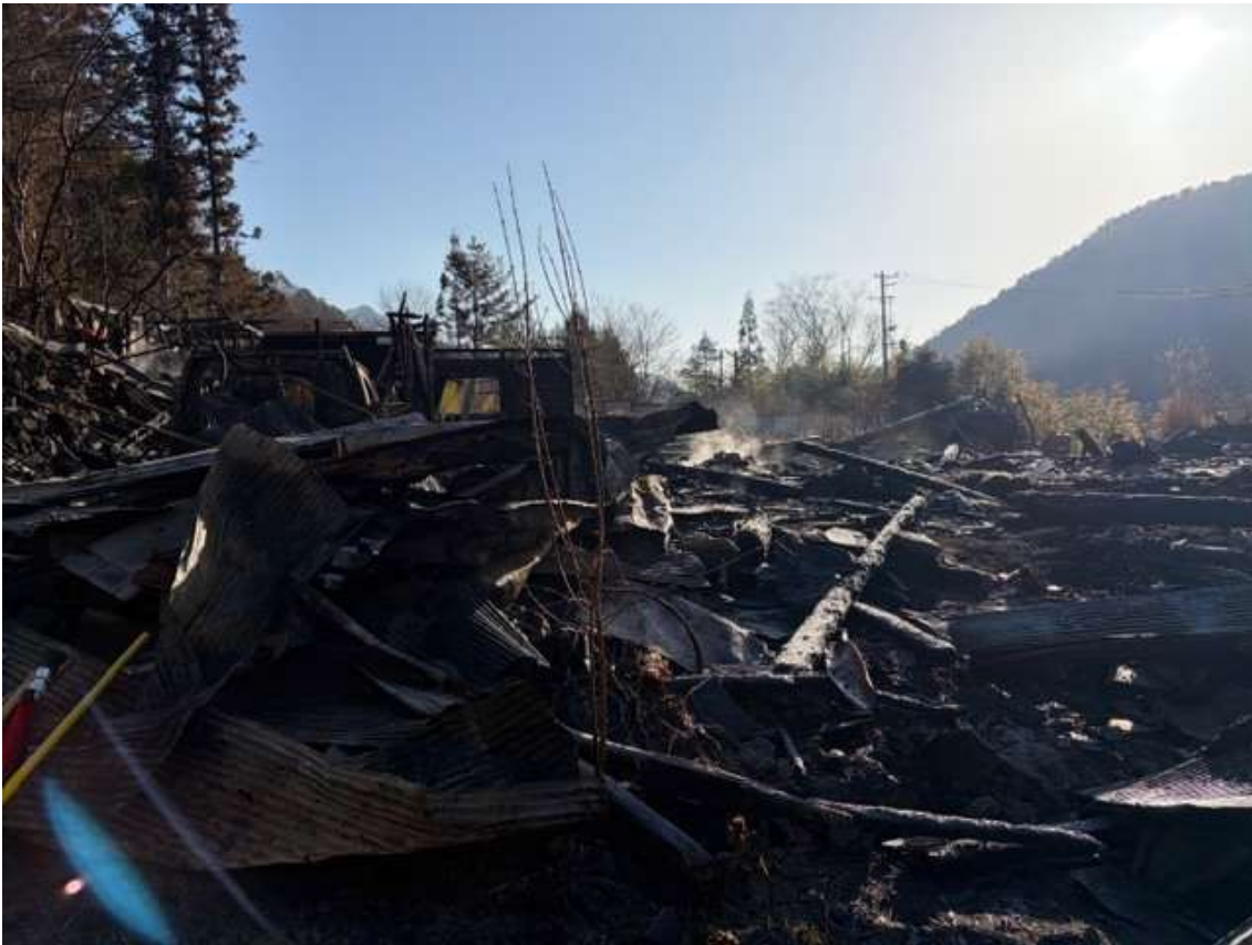
2月22日(日)朝 焼失した建物の状況
