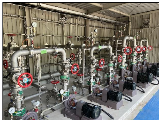
（集分湯室の送湯ポンプ）
