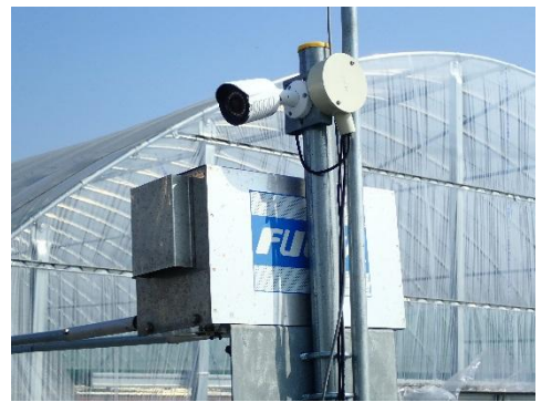
防犯カメラの設置
