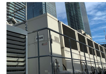
屋上の省エネ設備
